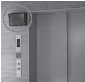
▲エレベーター内の様子が分かる外部モニター
