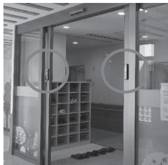
▲子供の届かない高さに設置された開閉スイッチ
