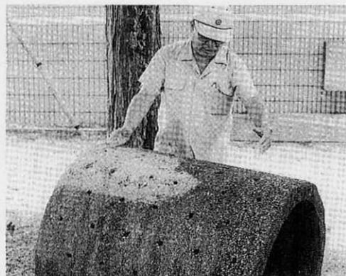
▲ 矢作川伏流水を取水する集水埋管
