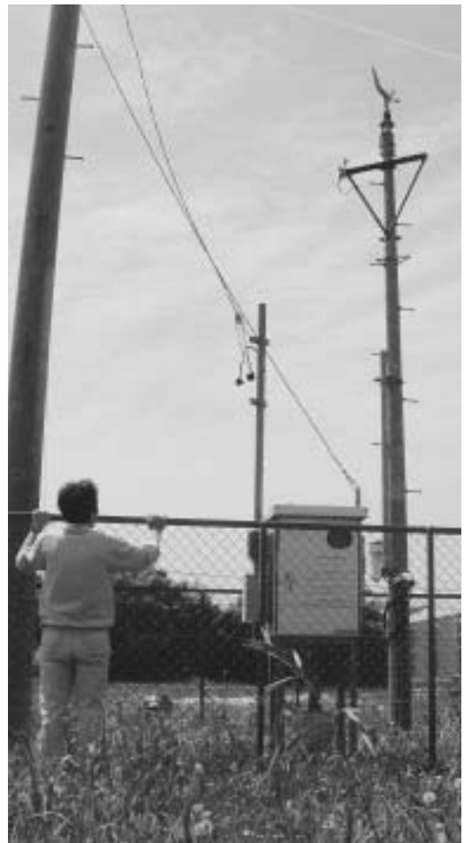
▲自動車や他の熱源の影響を受けず、自然に近い気象条件として設置された観測点 右の柱上は、10分ごとに計測される風向・風速計
