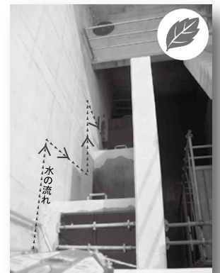
▲階段状に水を流し、施設内の電力を補う水力発電
