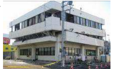
【地震により破壊された建物】
