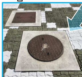
マンホール周辺(2年前塗装)
