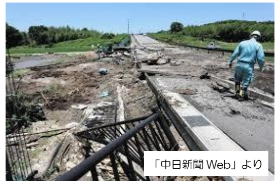
▲乙川の氾濫によって壊れた丸岡新橋付近の道路
